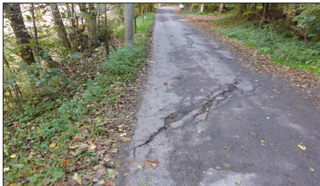
Obr. 28. Trhliny s poklesom cesty na okraji transportačnej oblasti zosuvu (foto J. Šimeková).
