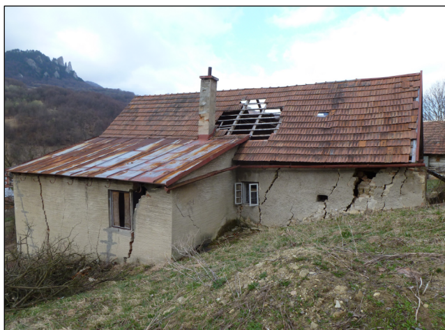
Obr. 10. Zosuvom poškodený dom č. 74 v obci Červený Kameň (foto P. Liščák).
