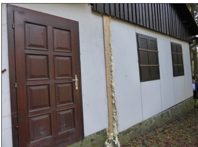
Obr. 27. a) Jedna z trhlín v teréne prechádzajúca na obvodový múr chatky; b) porušenie chatky č. 14 posuvom, následne opravené (foto J. Šimeková).
